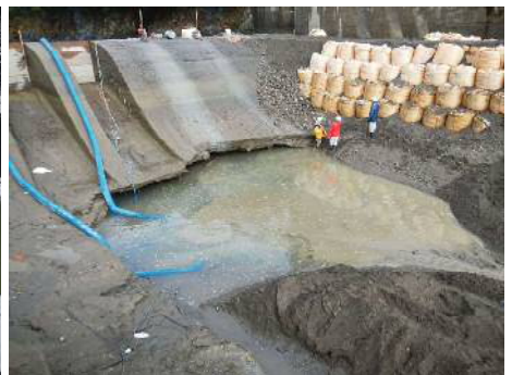
③ 下流エプロン被災状況
