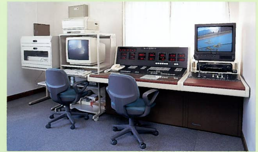
監視操作卓・CRT処理装置
