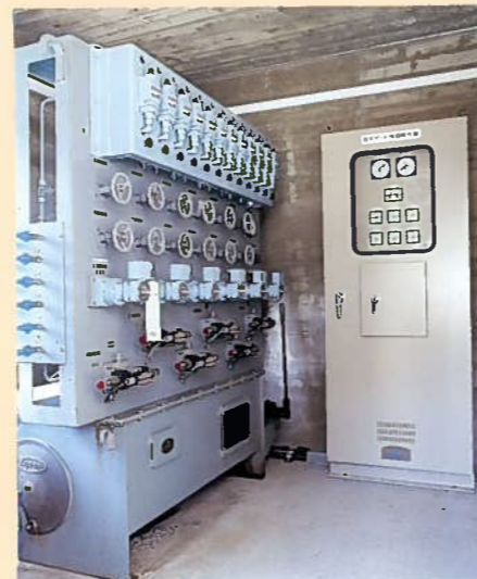
取水ゲート機側操作盤
