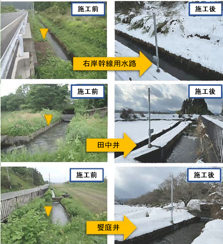
水位計設置 3箇所
